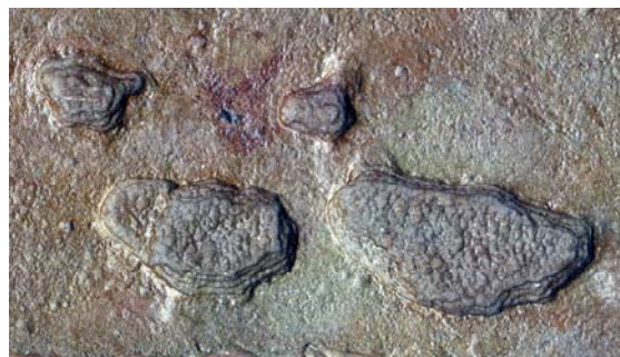
Коррозионные язвы, вызванные СРБ
